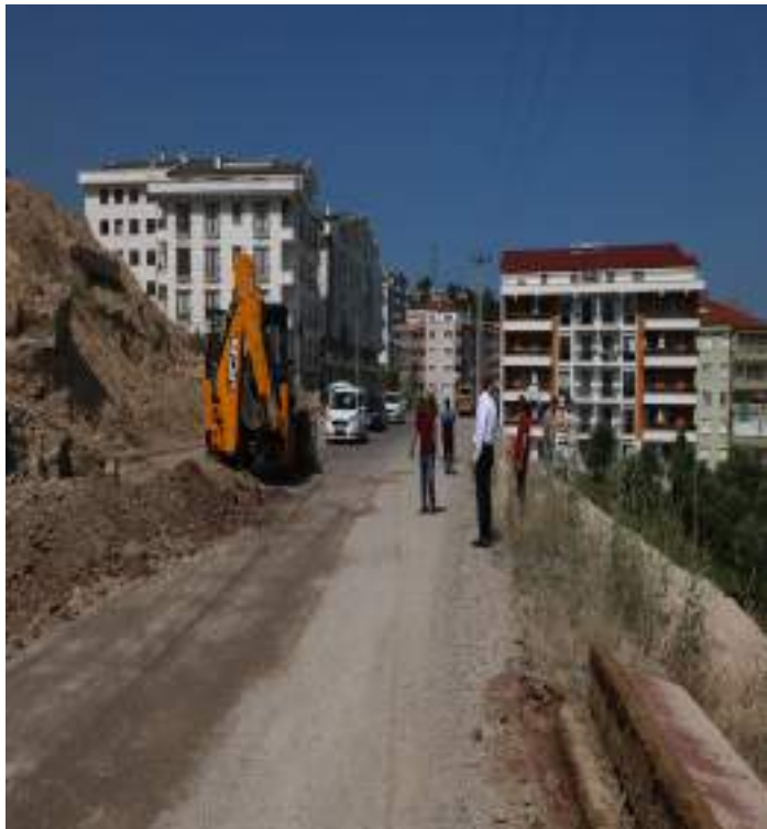
Poyraz Caddesi toprak kayması çalışması
